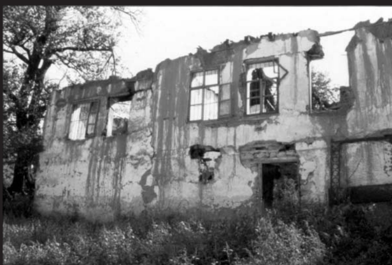
Северна фасада конака после паљења
